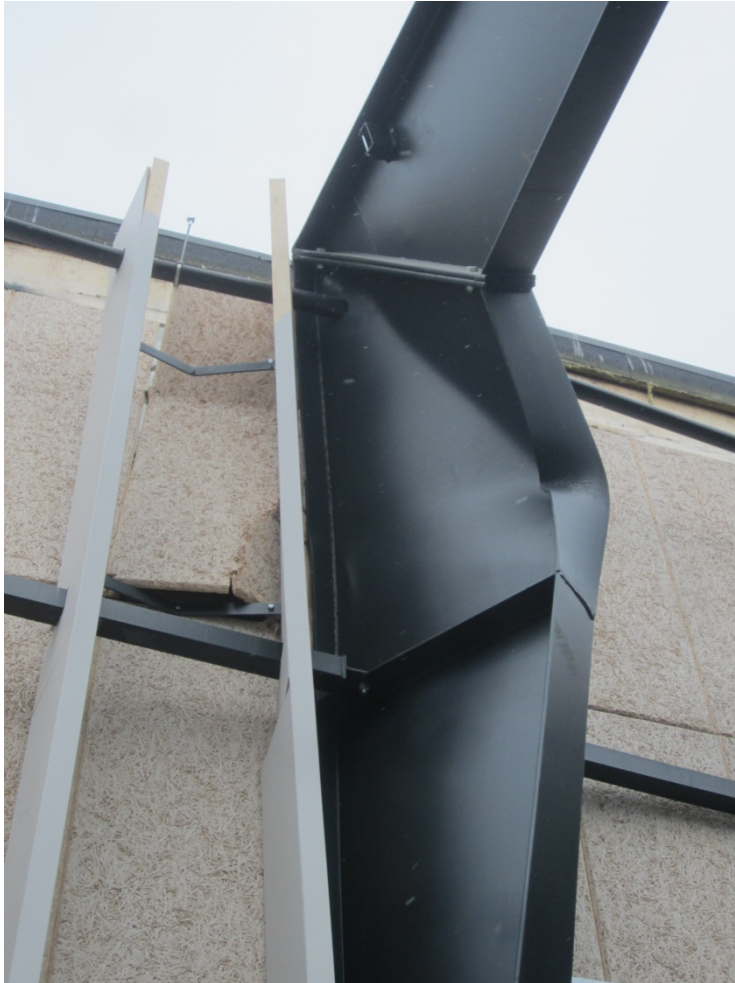
Foto 1. Stålramme med udknækning af trykflangen
